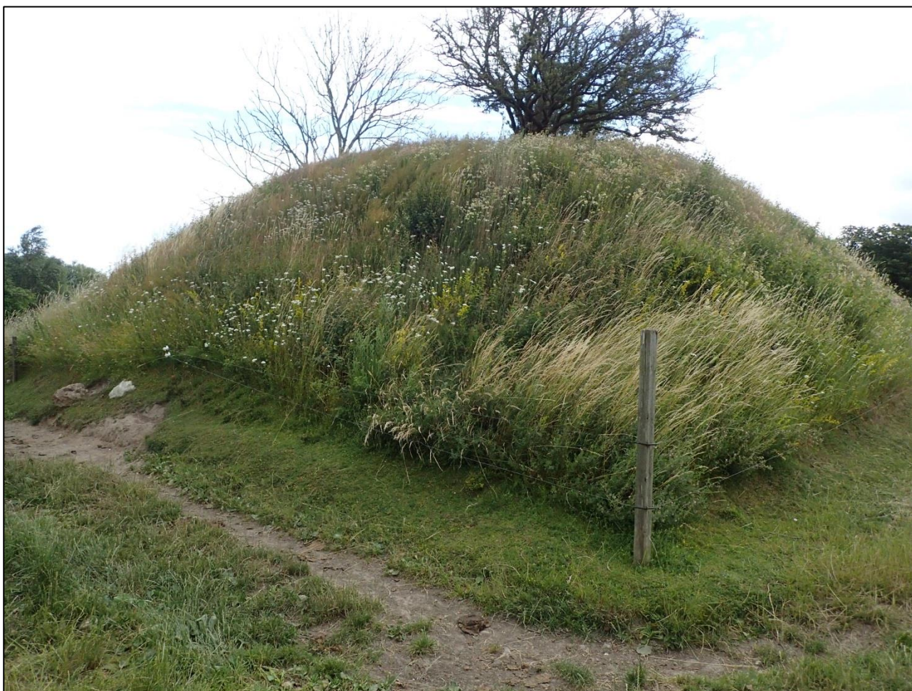
Frahegnet mindre gravhøj. På billedet ses tydeligt hårdt nedgræsset vegetation og slidskader på den nedre del af højen. Hegnet bør derfor flyttes minimum 3-4 meter ud fra højfoden.
