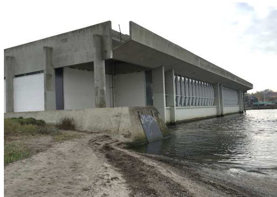
Figur 6. Vikingskibsmuseet. Fors' udløb ses som del af konstruktionen i forgrunden, med en kontraklap hvorpå der er malet graffiti.
